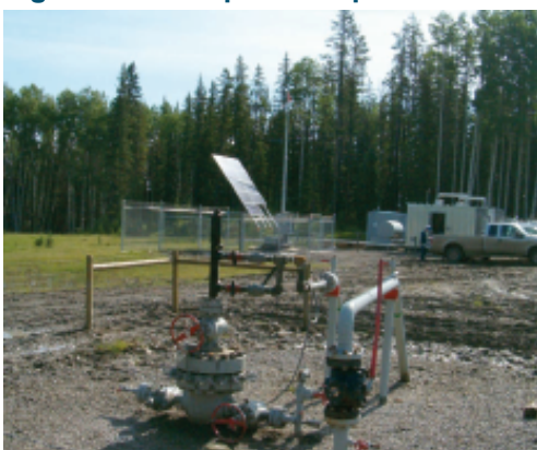
Figure 3b : Pompe chimique solaire
