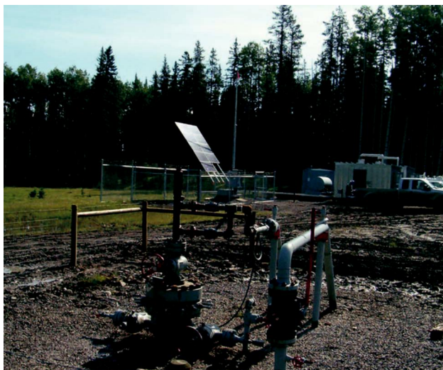
Figura 3b: Bomba química solar
